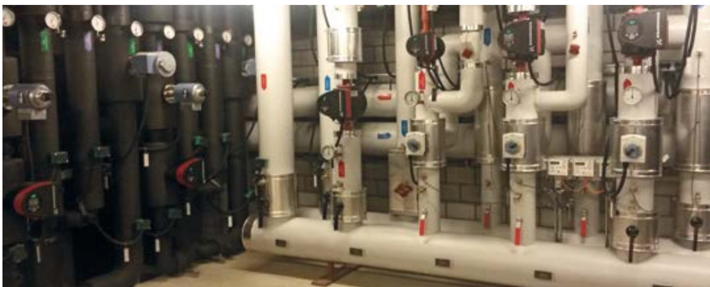
In solchen Infrastrukturanlagen steckt sehr grosses Energiesparpotenzial.
